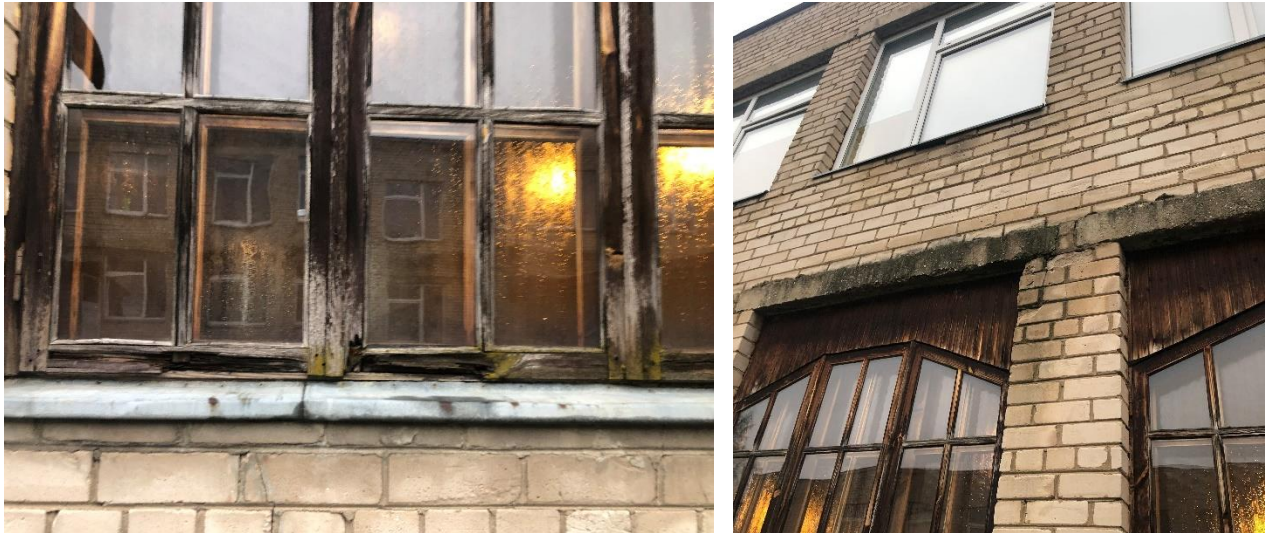
3 pav. Fasadų fragmentai su fiziškai susidėvėjusiais mediniais langais
